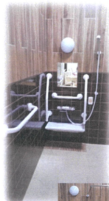
シャワー浴室
